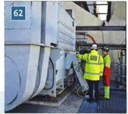
62 Schadstoffkiller im Kohlekraftwerk: Umrichter gesteuerte Motoren sorgen für Effizienz in Reduktionsanlage
